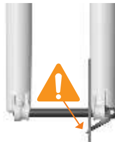
EIXO INSTALADO INCORRETAMENTE
